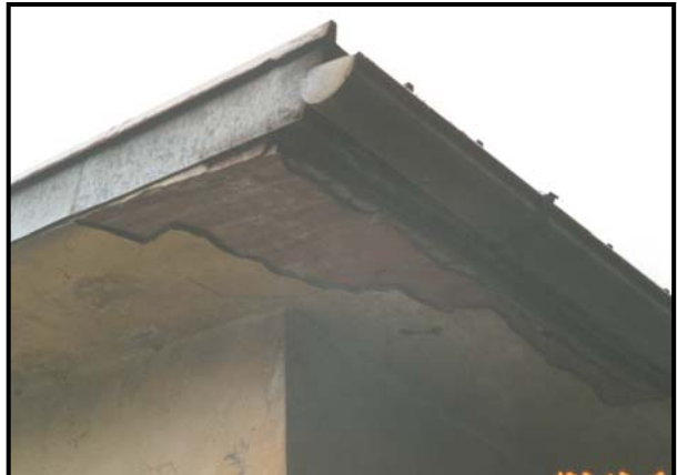
Gronda danneggiata e pericolante.
