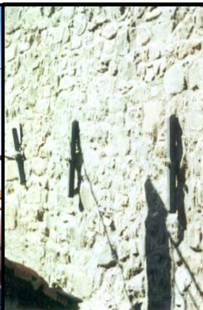
Paletto non correttamente inclinato, perché disposto in direzione verticale e per la mancanza di appoggio.
