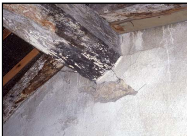
Danni provocati dal martellamento della trave di colmo.
