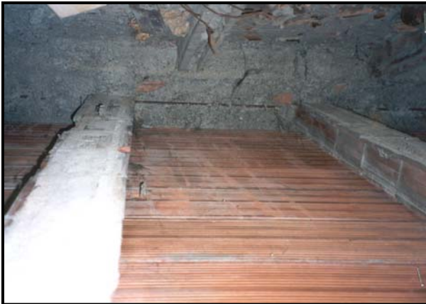
Controsoffitto in tavelloni di lunghezza 120 cm appoggiati su travetti tipo SAP in laterizio armato.
