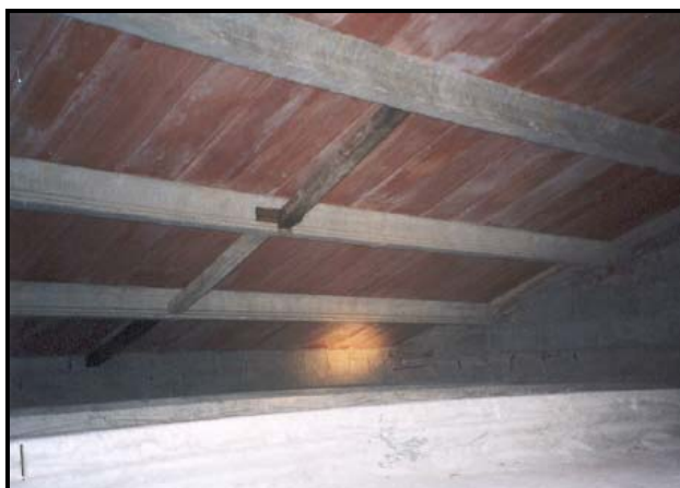
Copertura fragile e deformabile con travetti in c.a.p. e tavelloni (120 cm) disposti in senso non spingente.
